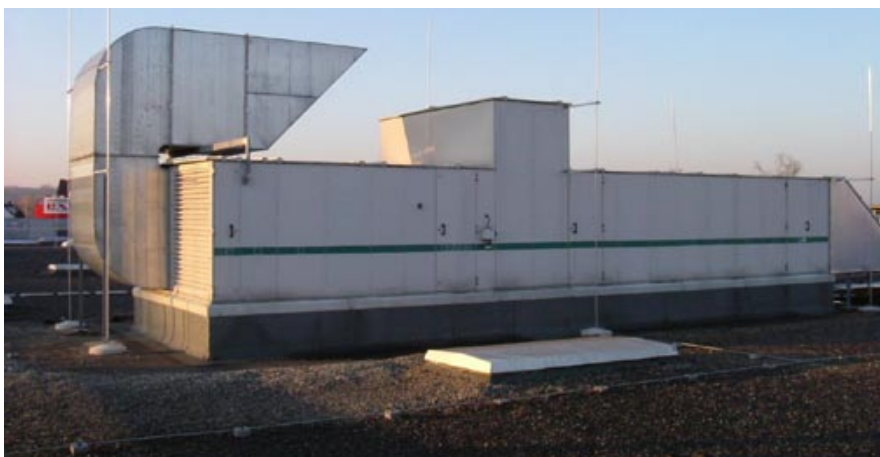
Zusätzlich installierte Bauten auf dem Dach – beispielsweise Klimageräte (Foto) – können die Statik eines Daches ebenso erheblich verändern ...
