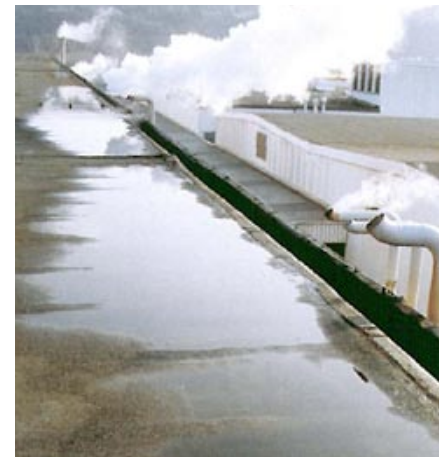
... wie eine nicht mehr funktionierende Dachentwässerung, die Pfützen und „Seen“ entstehen lässt.
